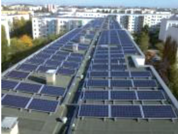
II.7. Widok dachu z instalacją PV na osiedlu Hellersdorf – Berlin. Źródło: [7];
