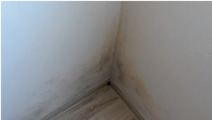
Il. 5. Zawilgocenie oraz grzyby pleśniowe w narożu pomieszczenia na parterze (autor).
