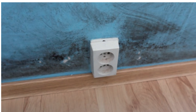
Il. 2. Grzyby pleśniowe wokół gniazdka elektrycznego oraz listwy przypodłogowej na parterze (autor).
