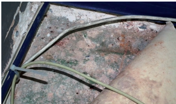
Il. 1. Grzyby pleśniowe pod wykładziną podłogową; strop nad wilgotną piwnicą (autor).
