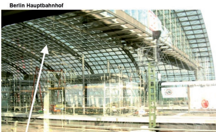
Il.3. Elementy fotowoltaiczne montowane na szklanym zadaszeniu dworca głównego w Berlinie. (fot. Anna M. Włodarczyk, 2014)
